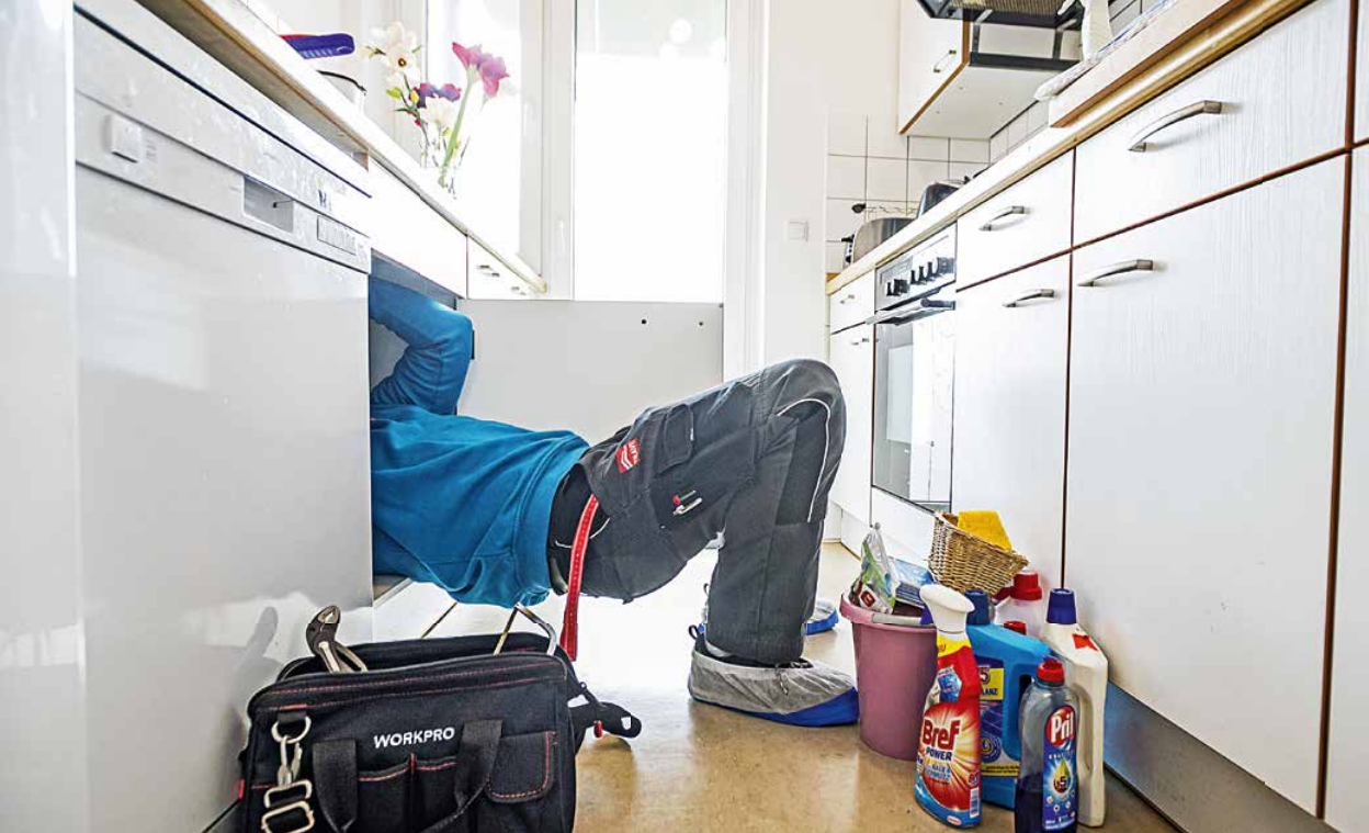
Termin bei Familie Reschke: Der Abfluss hat ein Leck. Schrank ausräumen, reinklattern und Dichtung erneuern.
