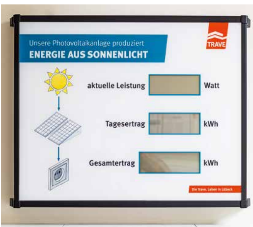
Eine LED-Tafel im Hauseingang 13 visualisiert künftig die Leistung und den Ertrag der Photovoltaik-Anlage.
